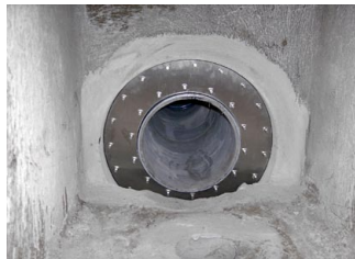
Innenansicht Rohwasserrinne Montiertes Ringraumdoppelement HBD am Zu- bzw. Ablauf des Filterbeckens.
