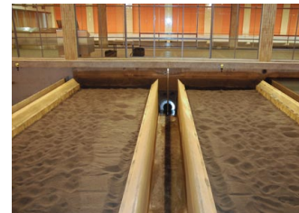
Filterbecken außer Betrieb Filterbecken mit Filterkies.
